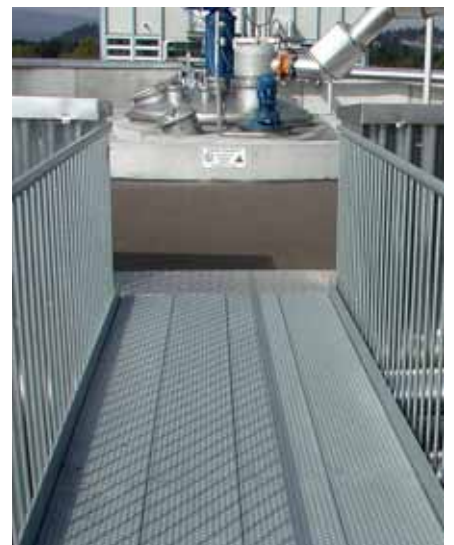
Fig. 18 Garde-corps avec des barreaux verticaux. L'espace entre les barreaux ne dépasse pas 180 mm.
