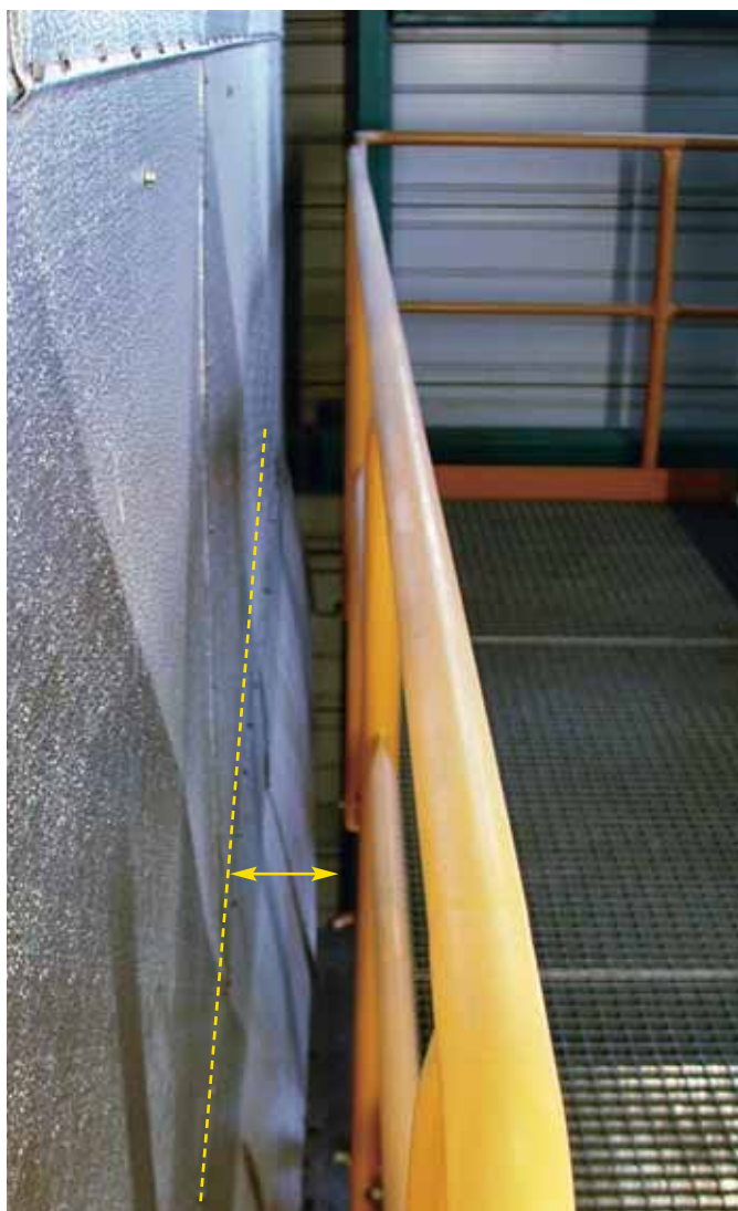
Fig. 7 Garde-corps servant à sécuriser des bords donnant sur le vide à proximité de murs ou de machines. L'installation d'un garde-corps est obligatoire, car la distance entre la passerelle et l'entourage de la machine dépasse 200 mm.
