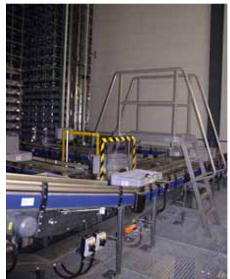
Fig. 6 Passerelle sécurisée latéralement par deux garde-corps. Cela empêche efficacement toute chute d'objets ou de personnes sur le convoyeur automatique. Les marches d'accès sont sécurisées par une main courante des deux côtés.
