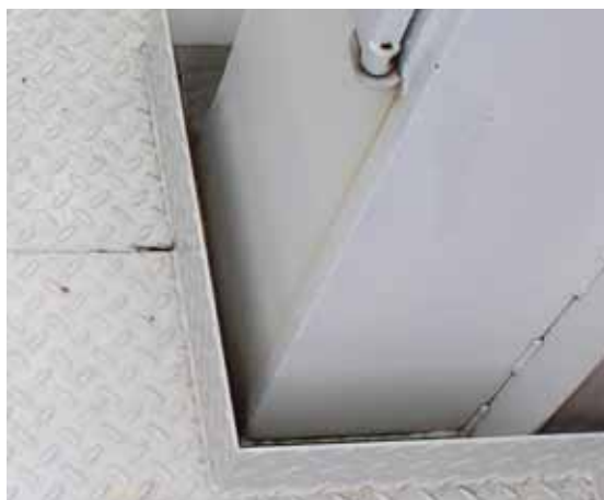
Fig. 9 Plinthe au bord d'une ouverture dans le sol, dont la distance horizontale par rapport au pilier est supérieure à 30 mm.
