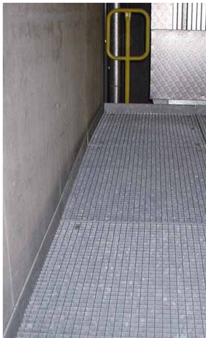
Fig. 8 Plinthe servant à sécuriser des bords donnant sur le vide à proximité de murs ou de machines. L'installation d'une plinthe est obligatoire, car la distance entre la passerelle et l'entourage de la machine dépasse 30 mm. A l'arrière, où la distance est supérieure à 200 mm, un garde-corps a été installé.
