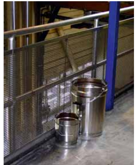
Fig. 17 Le grillage ajouté sur toute la surface du garde-corps empêche efficacement la chute dans le vide de personnes et d'objets.
