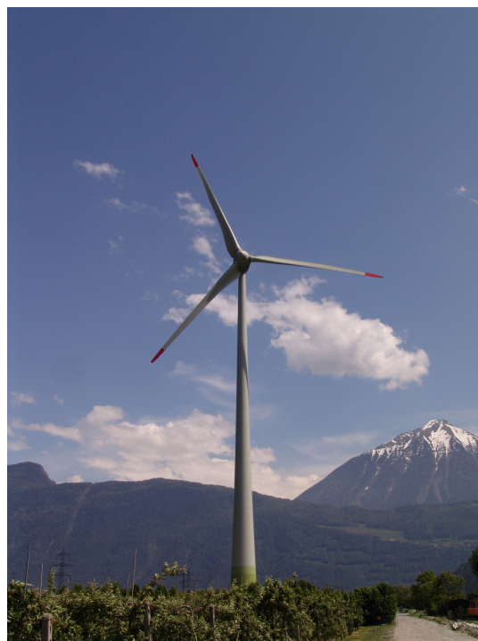
Figure 7 : Vue de l'éolienne E1 Mont d'Ottan en direction de Martigny.
