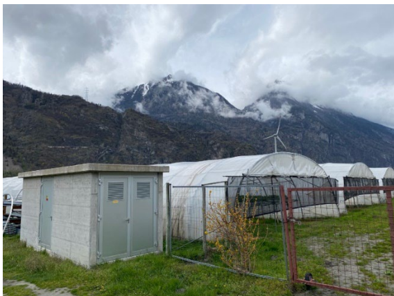
11 – Transformateur, route des Iles 3a, Martigny.
