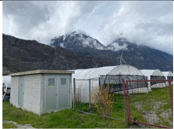
5 – Poste de transformation, route des Iles 3a, Martigny.
