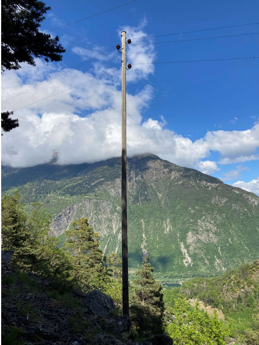
Photo 13 : Pylône 3 – Ligne Couplage Raverasses – Carrière Marin
