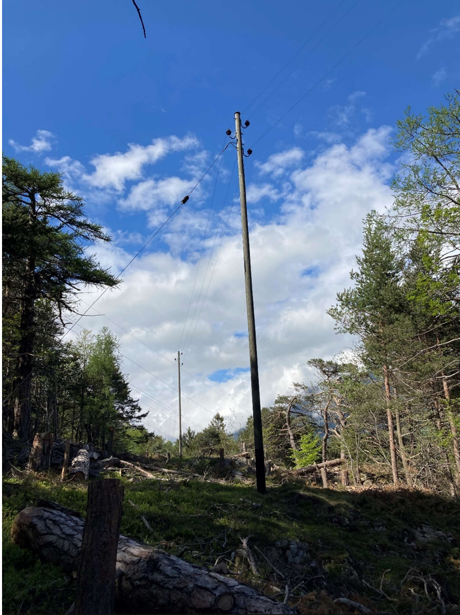
Photo 17 : Pylône 7 – Ligne Couplage Raverasses – Carrière Marin
