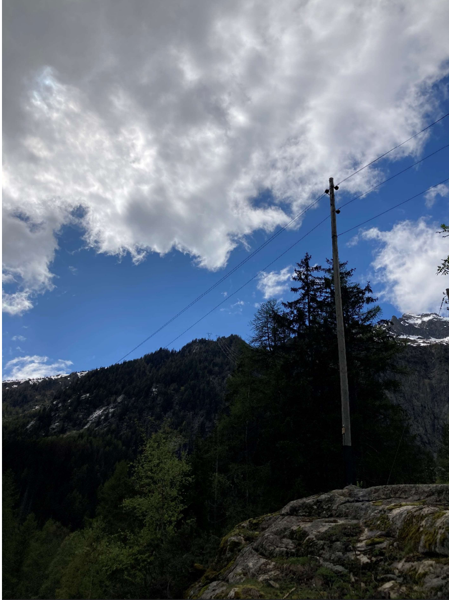
Photo 10 : Pylône 12 - Ligne Châtelard Frontière – Hôpital
