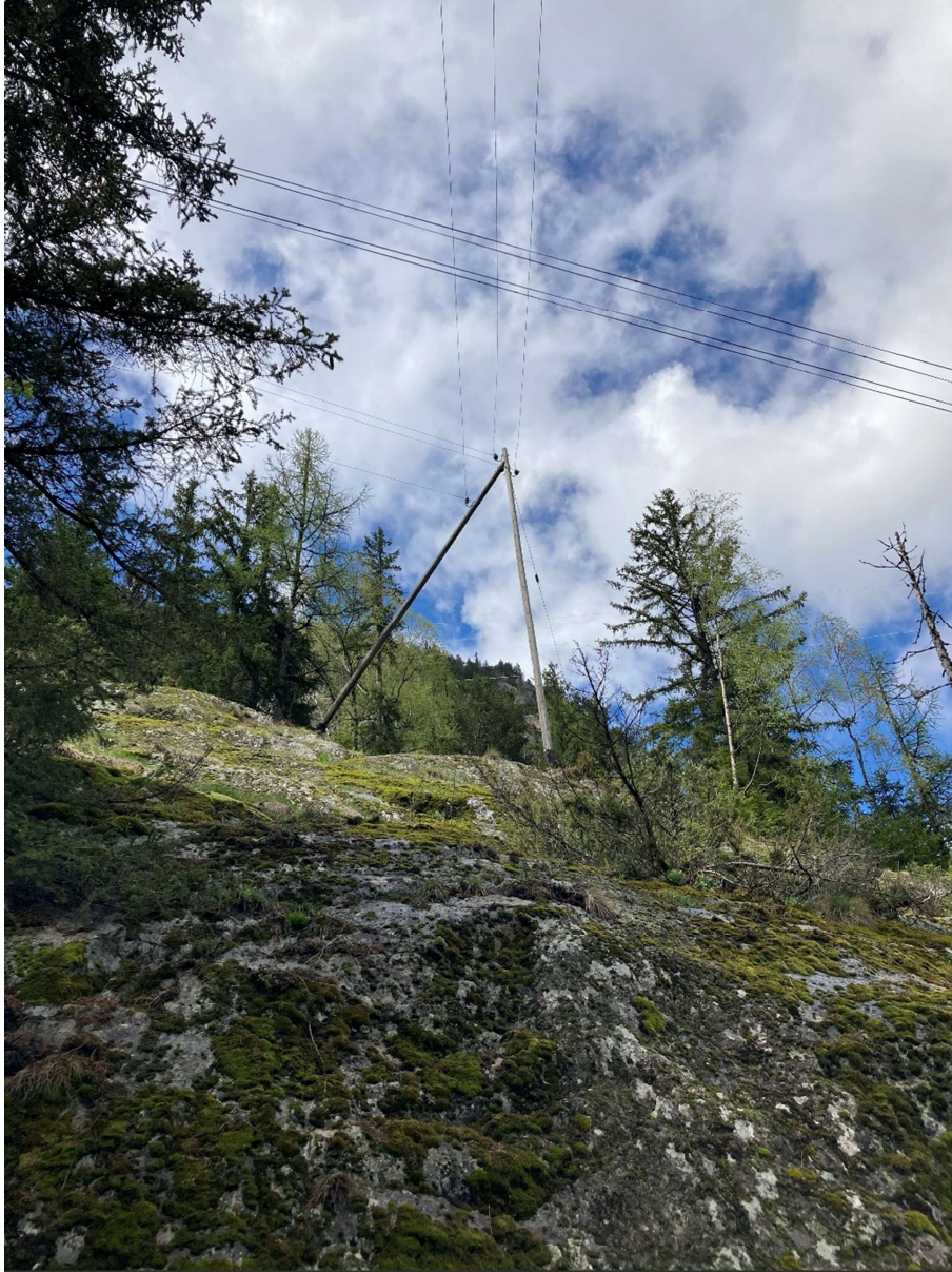
Photo 3 : Pylône 3- Ligne Châtelard Frontière – Hôpital
