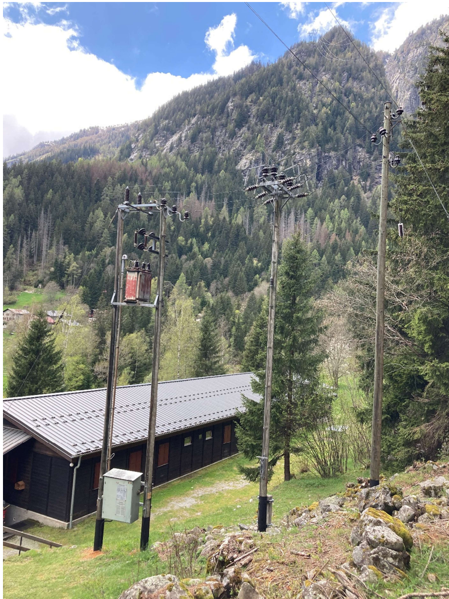
Photo 9 : Pylône 9 – 10 – 11 (de droite à gauche) - Ligne Châtelard Frontière – Hôpital
