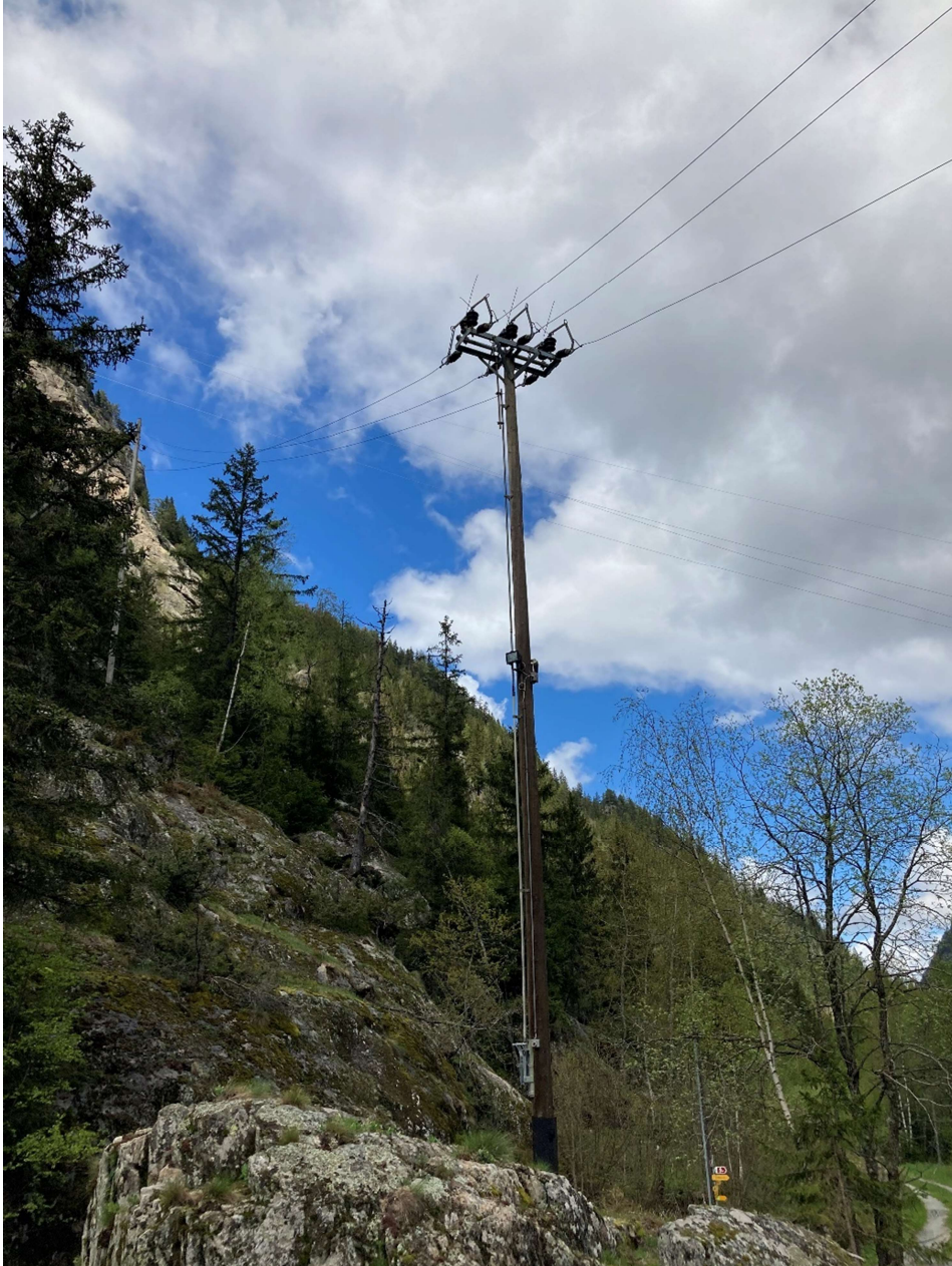
Photo 2 : Pylône 2 - Ligne Châtelard Frontière – Hôpital
