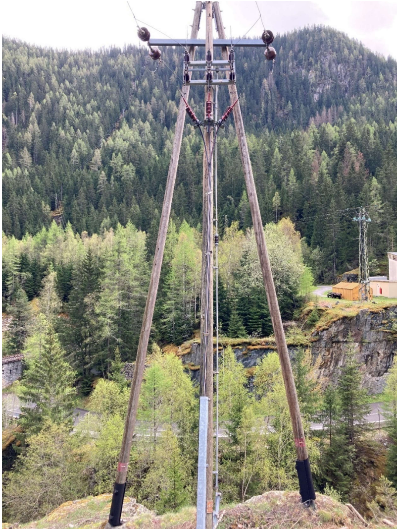
Photo 1 : Pylône 1 - Ligne Châtelard Frontière – Hôpital
