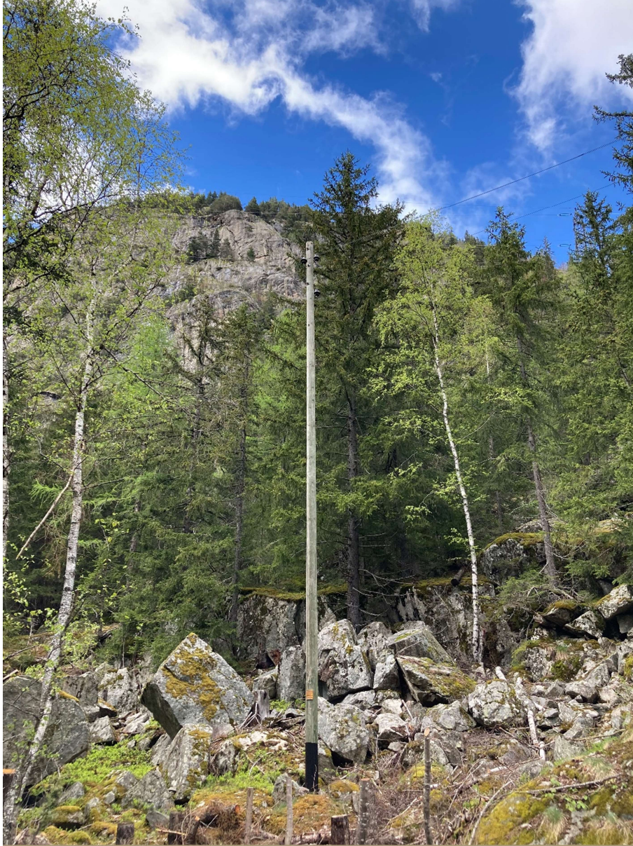
Photo 6 : Pylône 6- Ligne Châtelard Frontière – Hôpital
