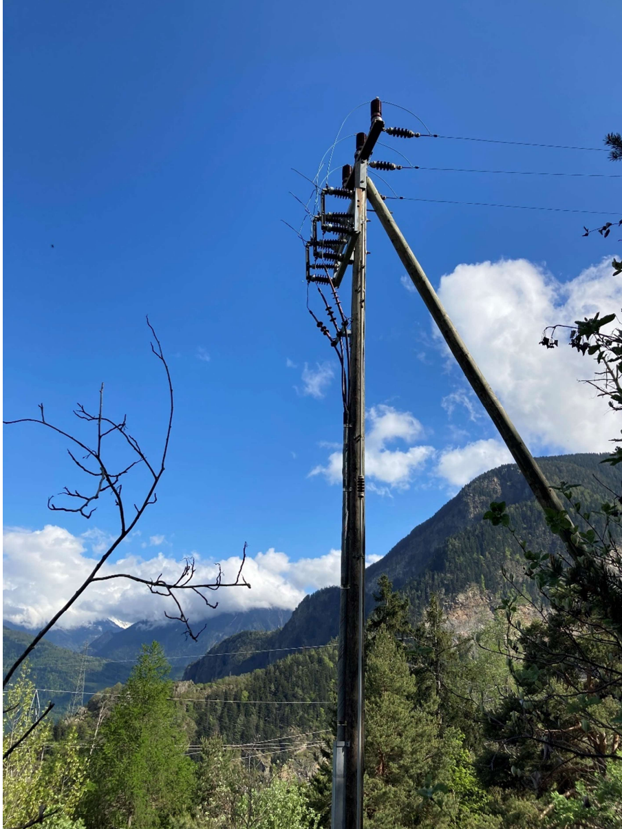
Photo 23 : Pylône 13 – Ligne Couplage Raverasses – Carrière Marin
