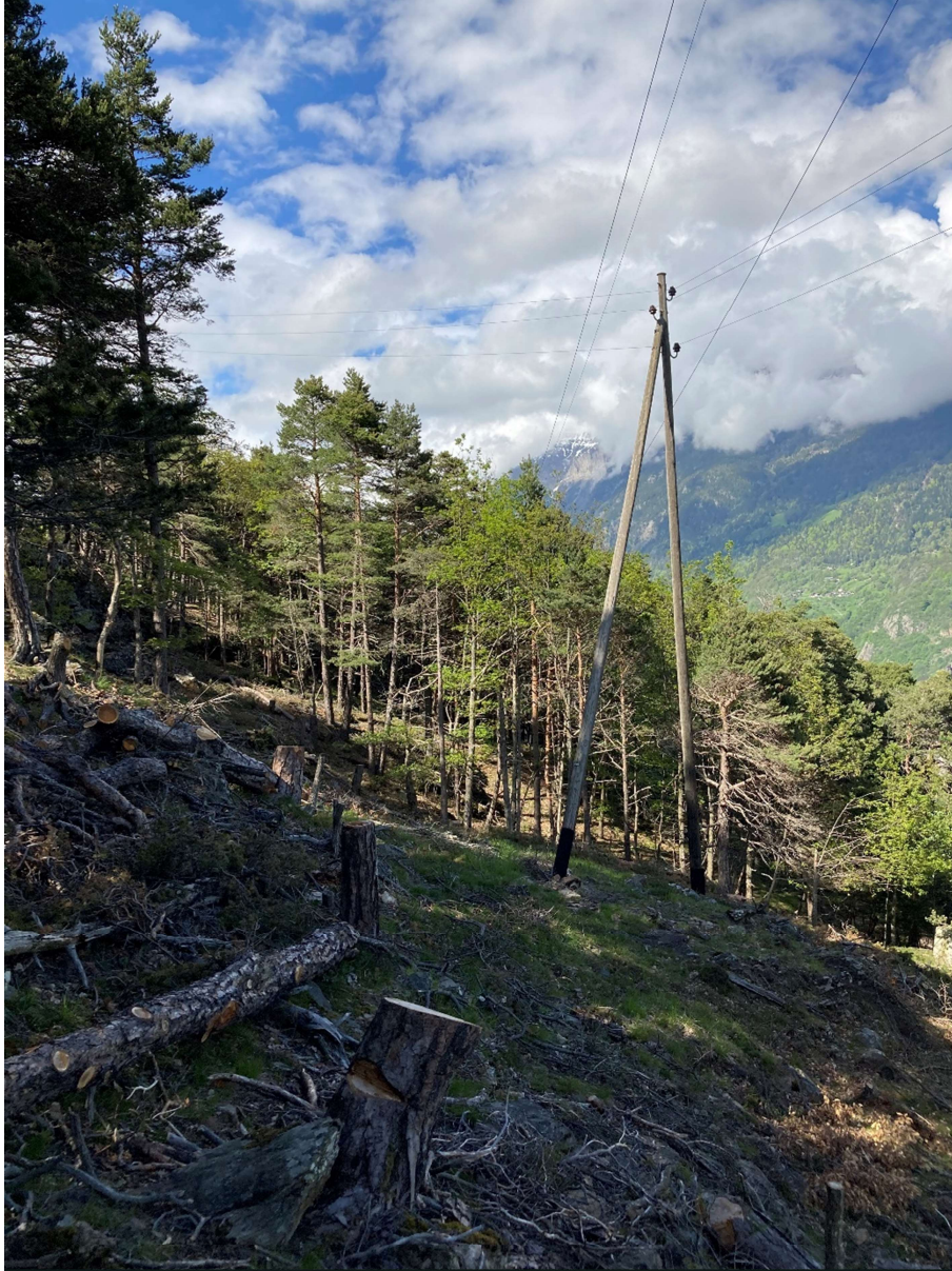
Photo 14 : Pylône 4 – Ligne Couplage Raverasses – Carrière Marin
