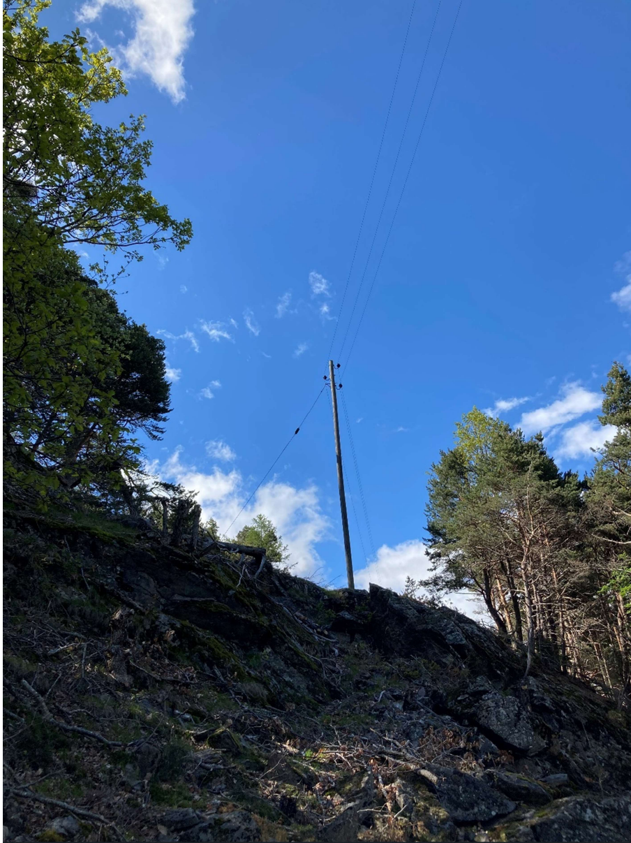
Photo 15 : Pylône 5 – Ligne Couplage Raverasses – Carrière Marin
