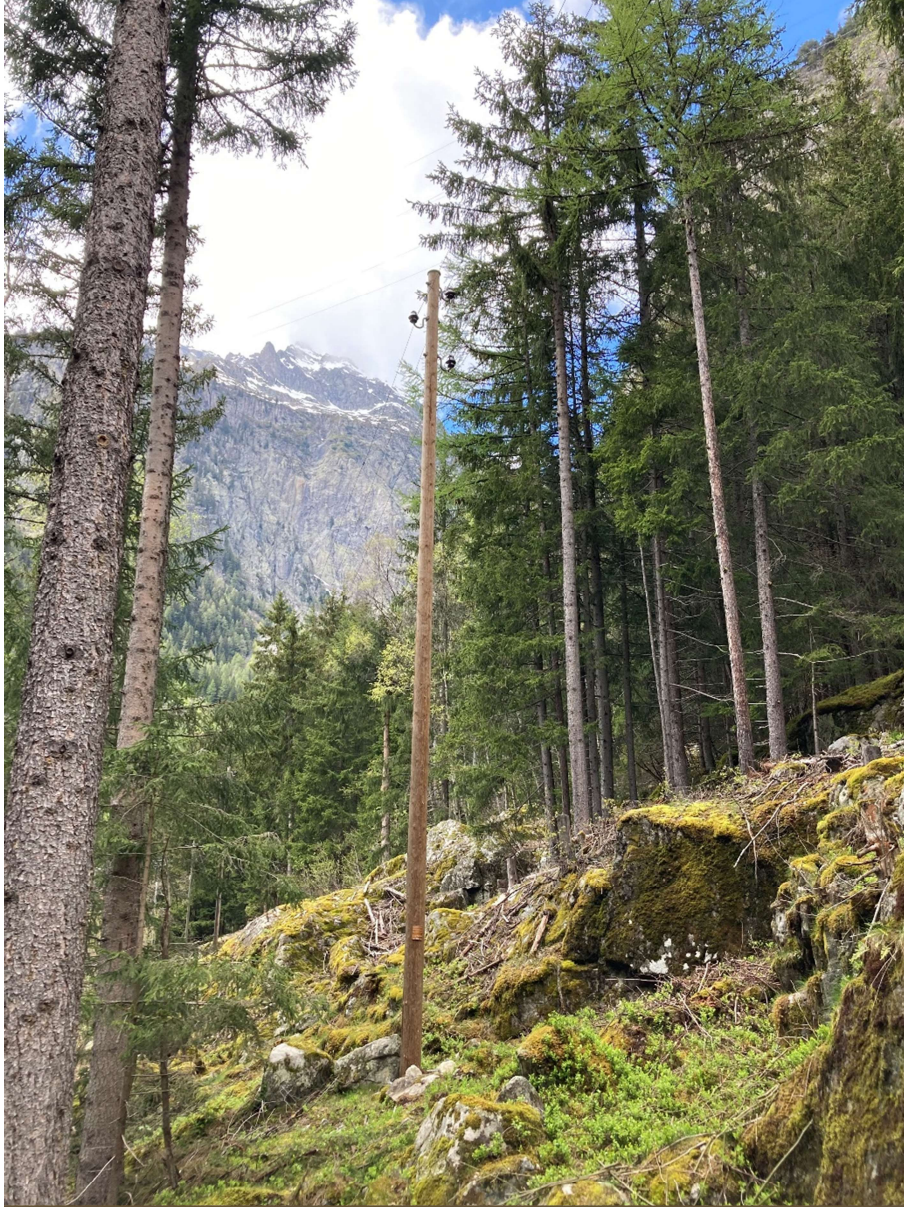
Photo 7 : Pylône 7- Ligne Châtelard Frontière – Hôpital
