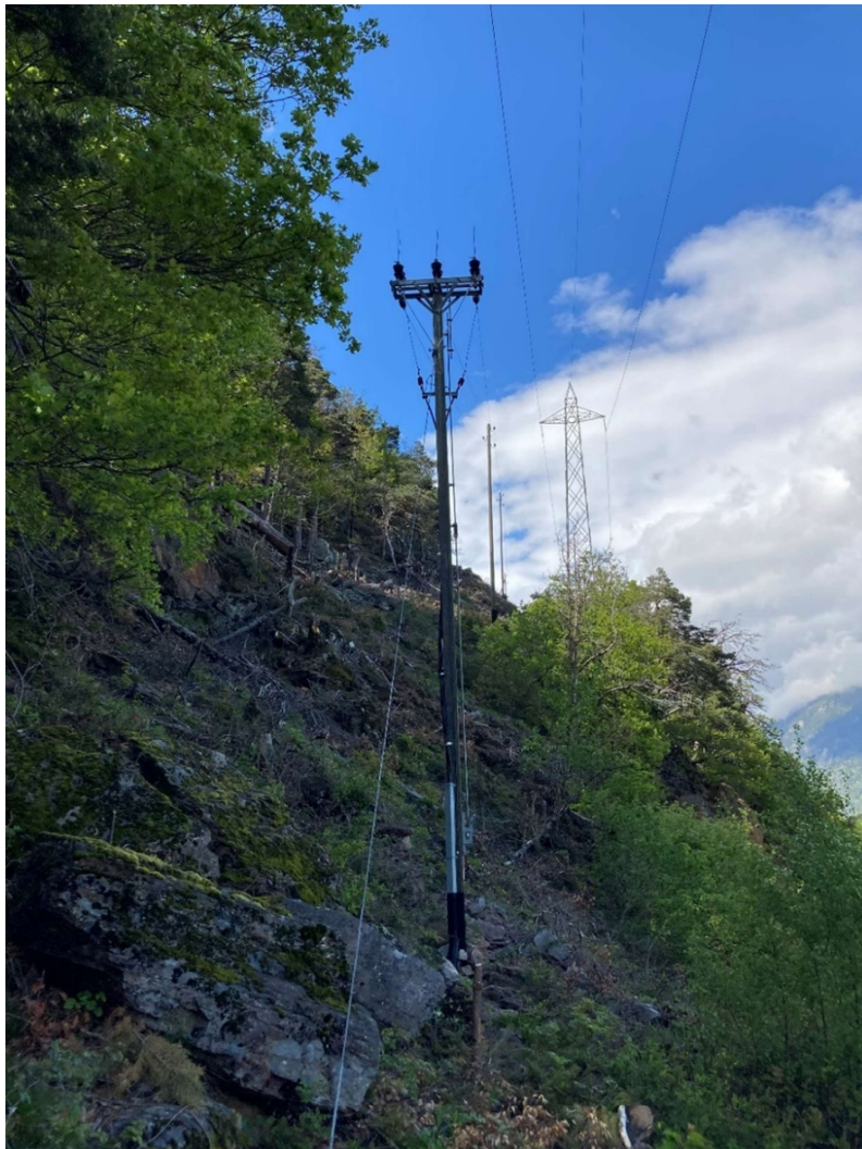
Photo 11 : Pylône 1 – Ligne Couplage Raverasses – Carrière Marin
