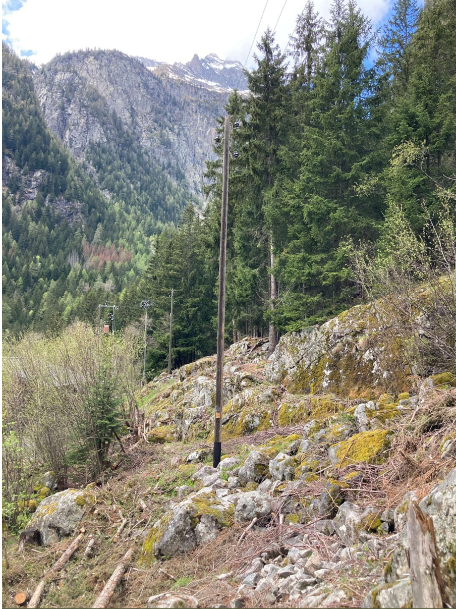
Photo 8 : Pylône 8- Ligne Châtelard Frontière – Hôpital
