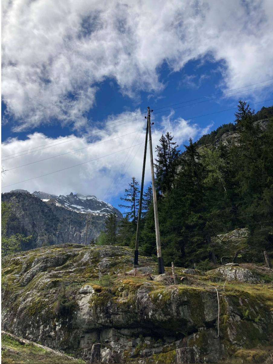
Photo 4 : Pylône 4- Ligne Châtelard Frontière – Hôpital
