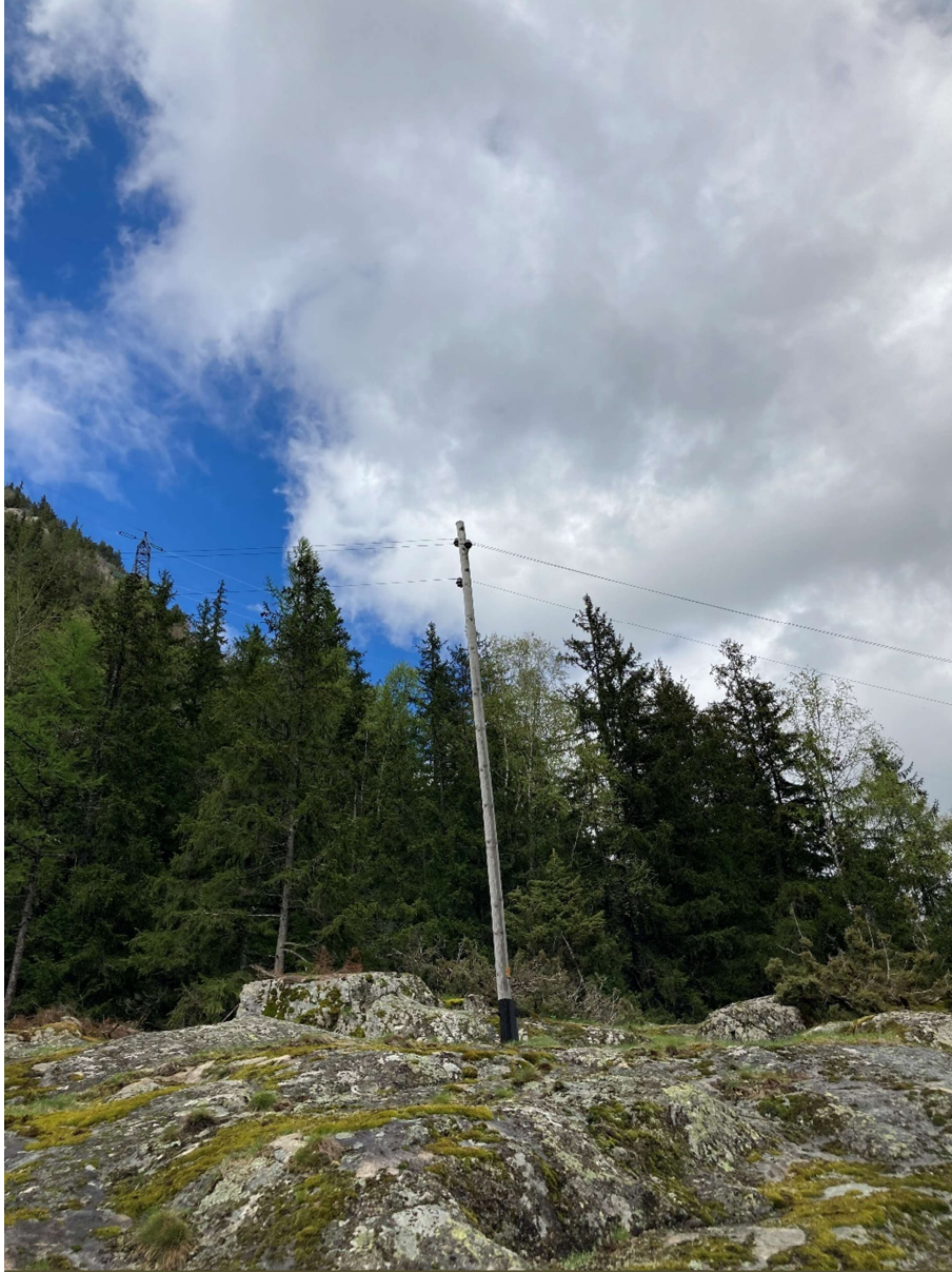
Photo 5 : Pylône 5- Ligne Châtelard Frontière – Hôpital
