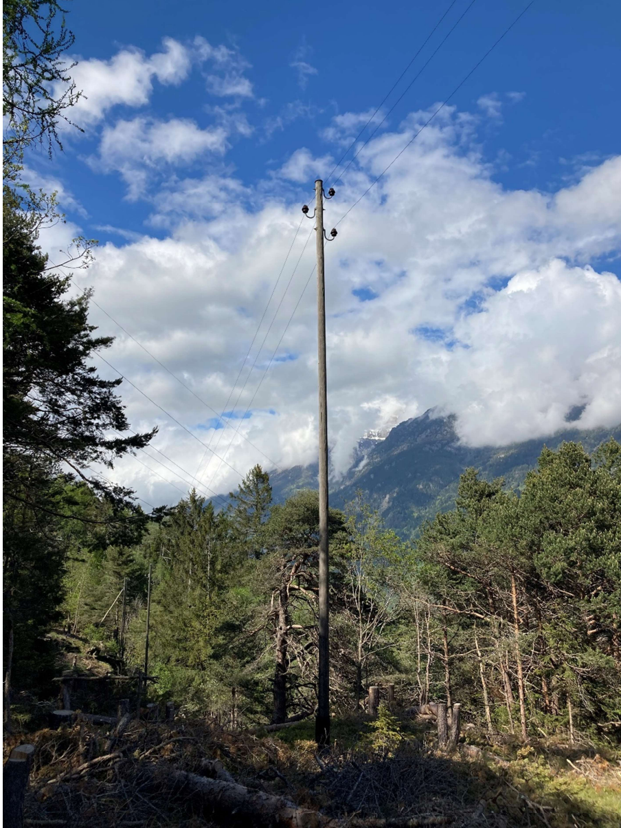
Photo 18 : Pylône 8 – Ligne Couplage Raverasses – Carrière Marin
