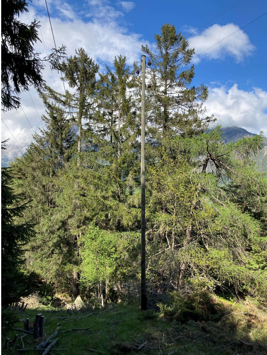
Photo 19 : Pylône 9 – Ligne Couplage Raverasses – Carrière Marin
