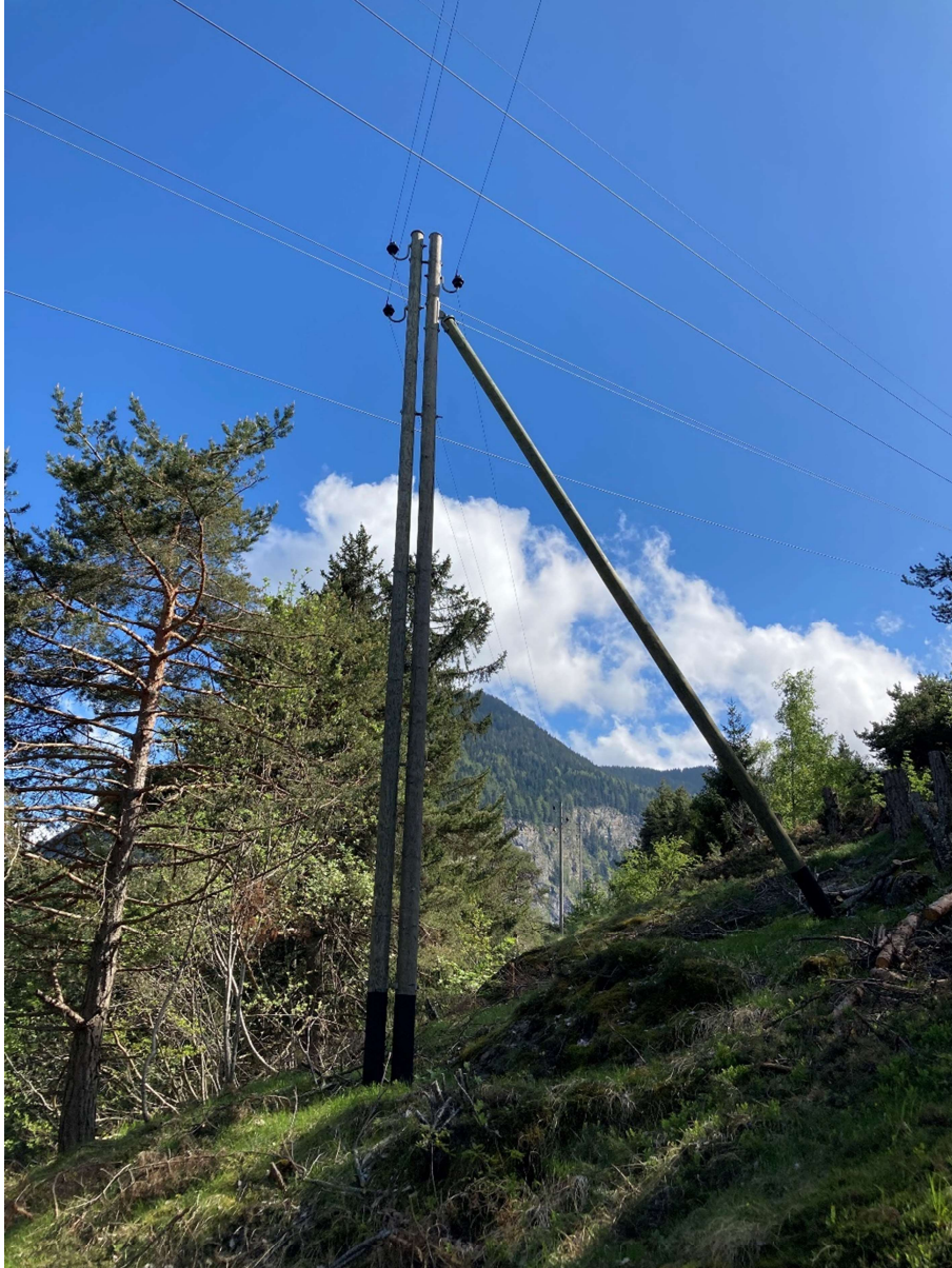
Photo 20 : Pylône 10 – Ligne Couplage Raverasses – Carrière Marin
