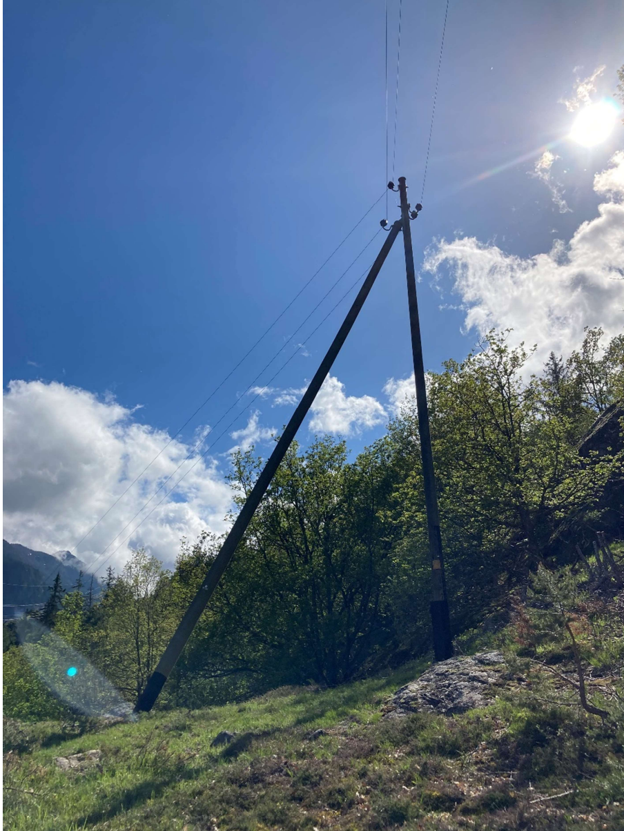
Photo 22 : Pylône 12 – Ligne Couplage Raverasses – Carrière Marin
