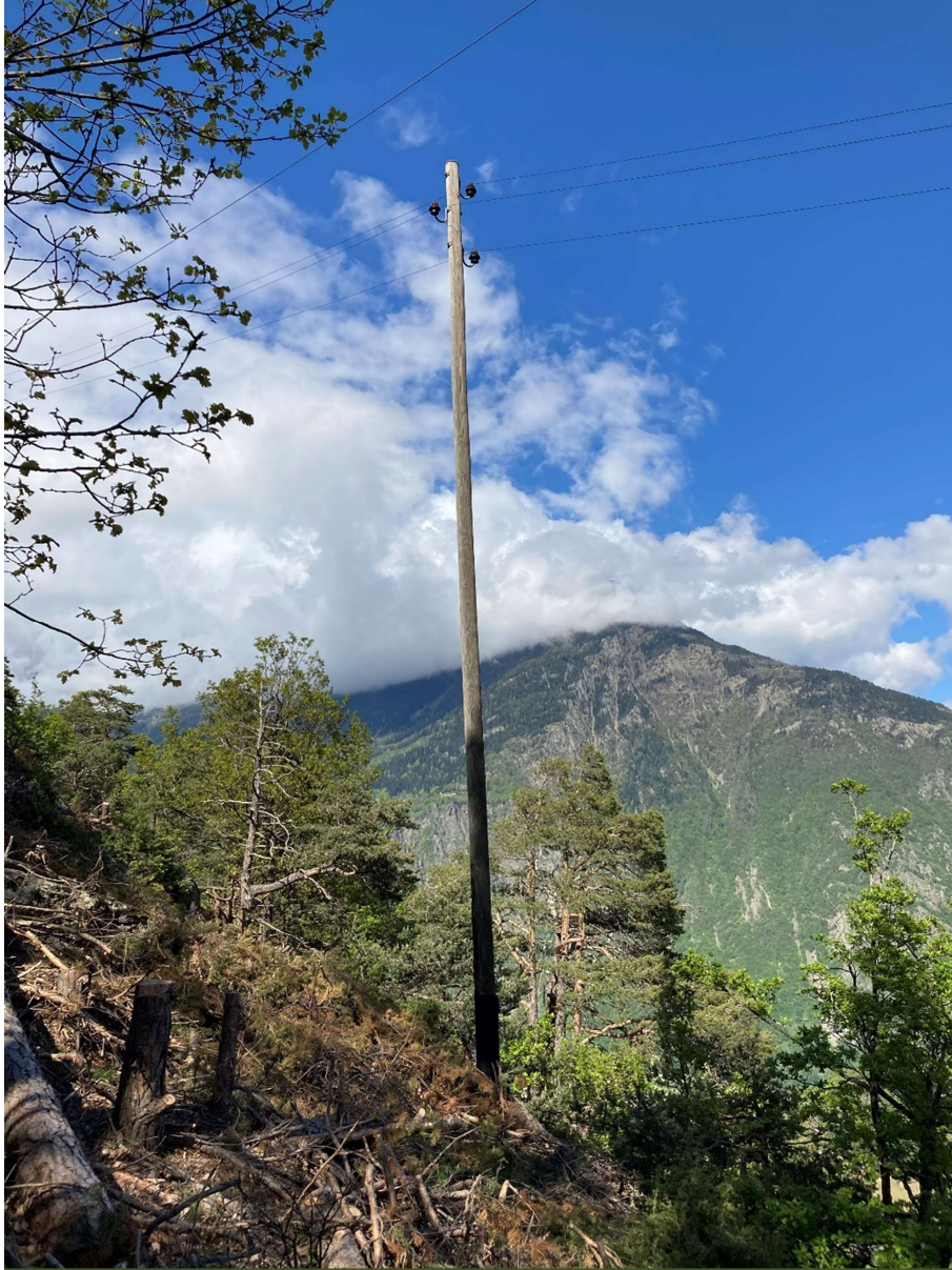
Photo 12 : Pylône 2 – Ligne Couplage Raverasses – Carrière Marin
