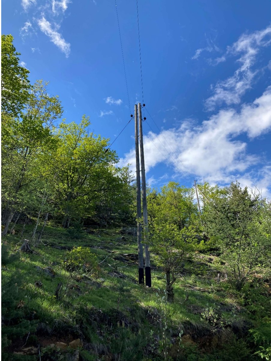
Photo 21 : Pylône 11 – Ligne Couplage Raverasses – Carrière Marin
